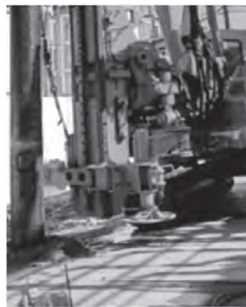
<鋼管杭打設工事> AMZ工法・TGパイル工法・ケンマパイル工法
