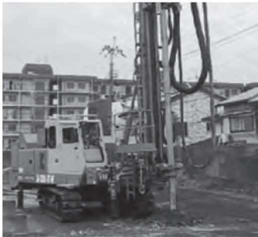
<地盤改良工事> 建築技術性能証明工法 (GIコラム工法・SSコラム工法)
