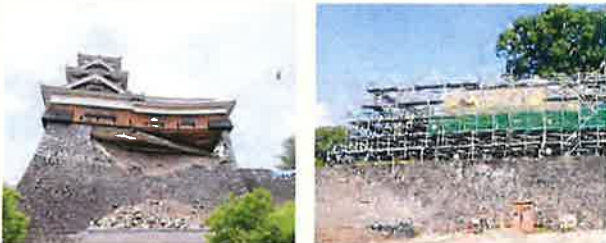
地震直後の飯田丸櫓の石垣と修復中の同石垣
