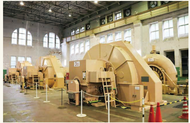
本館内に並ぶ発電機と水車
